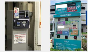
駐車場入口にインターホンを設置している事例 駐車場入口での満空状況表示
