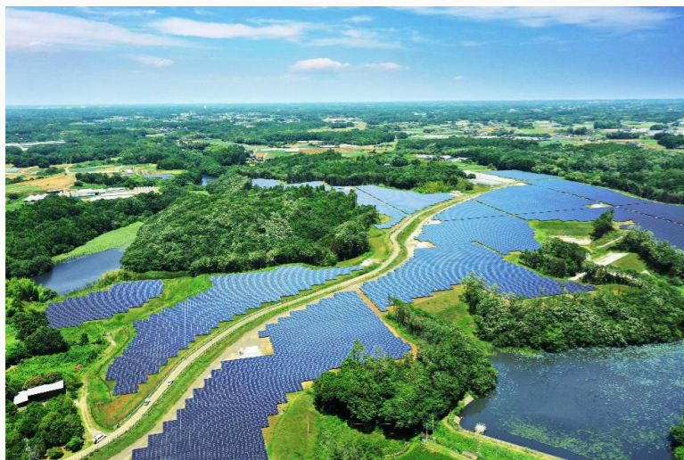
リエネ行方 太陽光発電所 定格容量：28.3MW
