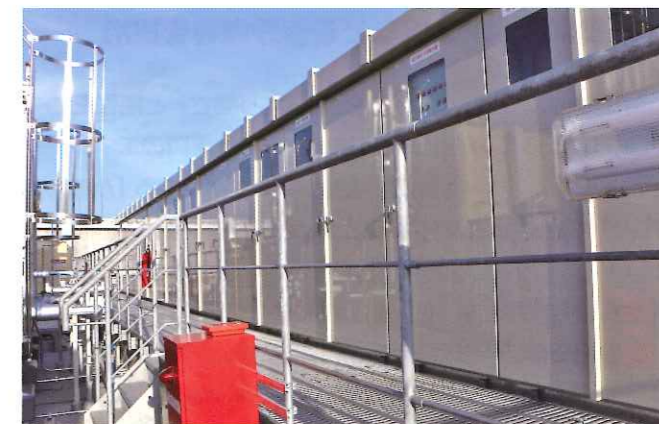
屋上に並ぶ各種設備機器
